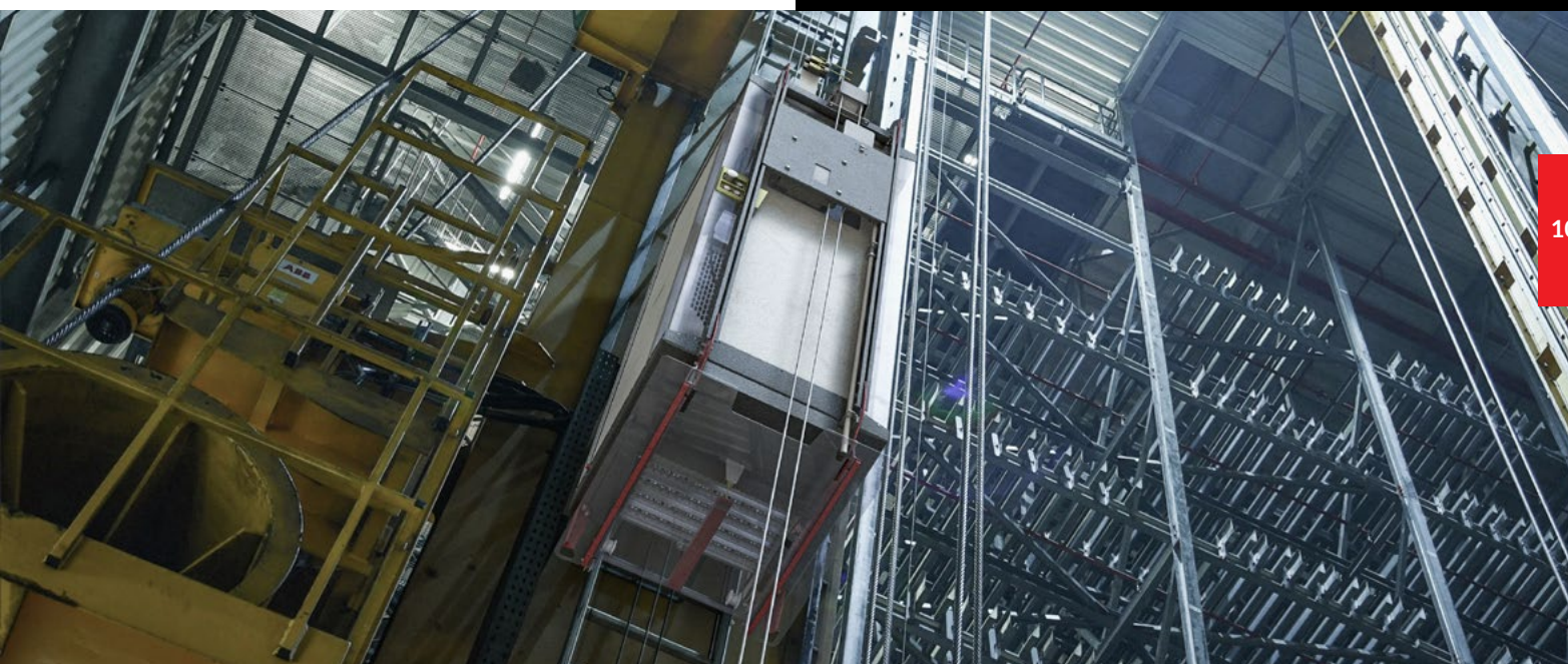
Hochregallager (Frankfurt), TOPlift, 40 m Fahrstrecke
