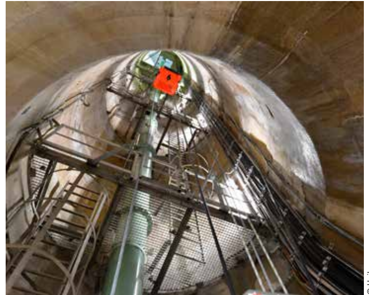
Durch den Schieberschacht bringt der seilgeführte GlobalLift Ralf Berg und seine Kollegen zu den Entnahmeeinrichtungen auf mittlerer Ebene und zur unteren Schieberkammer.
